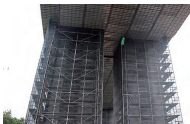
高速道路橋脚 上部工のつりだ足場SKパネルと組み合わせて設置
